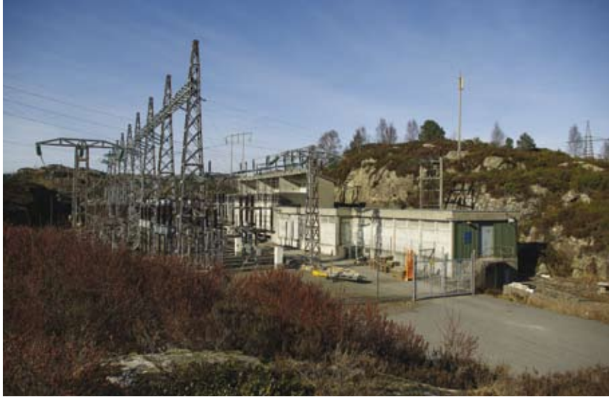
Transformatorstasjonen nord for Rv. 555, mellom rådhuset og Arefjorden. Foto: KA
